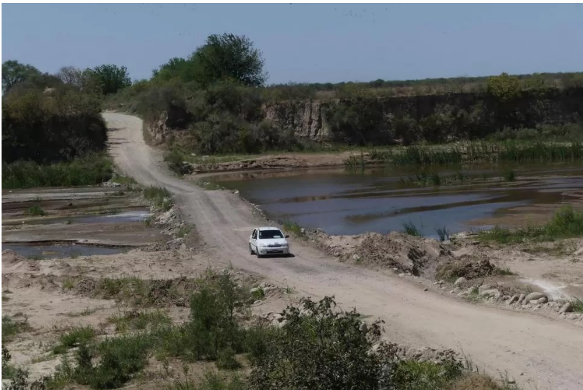
Figura 6-B- Cruce del río San Francisco en RP 334. Se aprecia la gran profundización del cauce provocado por la erosión de los suelos
